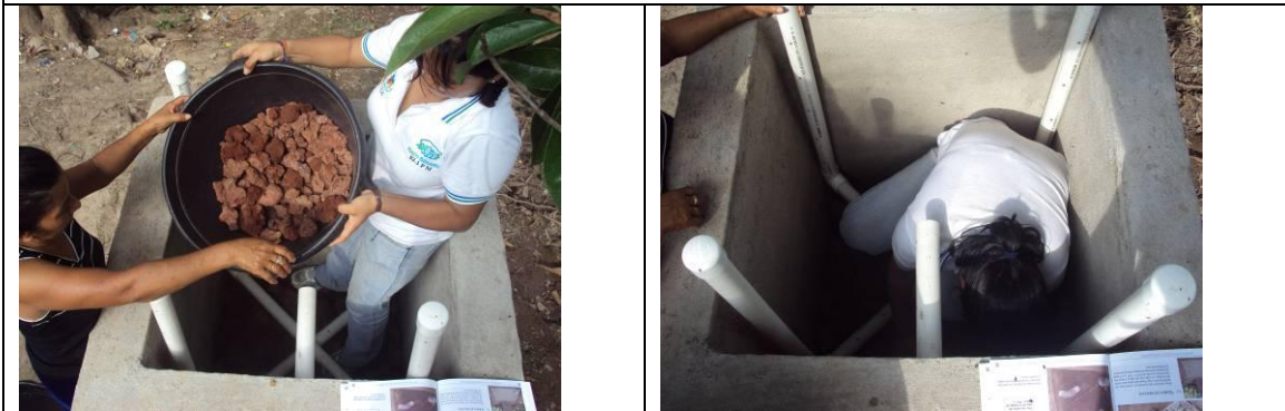
Acá ya se esta haciendo el llenado capa por capa de piedra volcán desde la mas grande hasta las mas finas (material colado).
