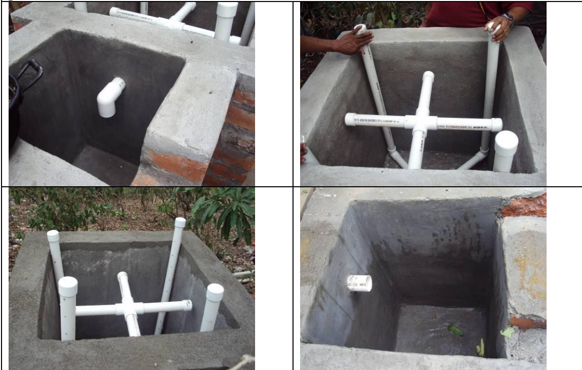
En estas fotografías se muestran algunos detalles de los biofiltro como lo es la trampa de grasa los accesorios de la trampa de grasas y de la caja filtrante. Las crucetas de descarga de agua gris y los tubos de respiración de carga bacteriológica que se criaran en la piedra volcánica.
