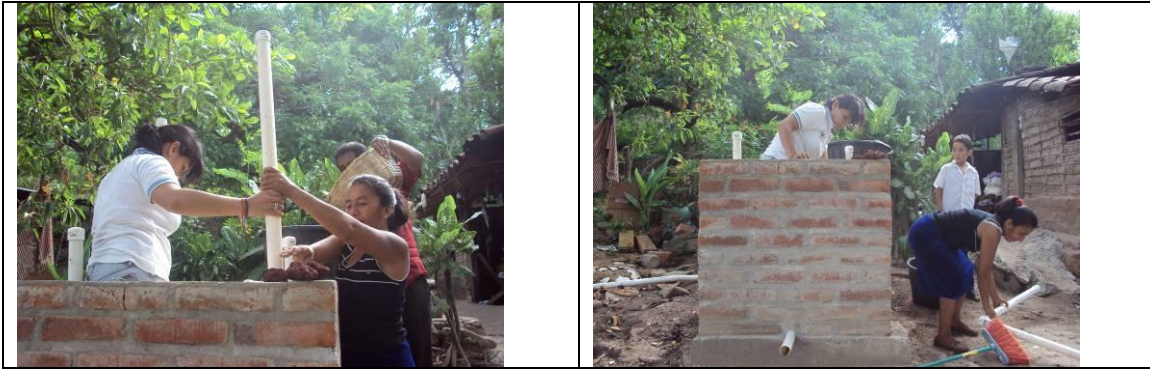
Se le esta explicando a la Señora Estela Monjes como colocar los tubos de ventilación, para que se de la aeración de la carga bacteriológica y se esta seleccionando las piedra volcánicas mas grandes para ubicar la primera capa en el fondo de la caja filtrante.
