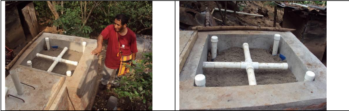
Se muestra un biofiltro para el tratamiento de las aguas grises ya completamente lleno con el material para su utilización, la cual no se había autorizado al momento pero después de la inspección esta ya esta en funcionamiento.
